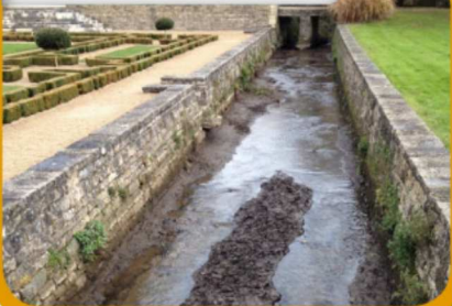
Envasement d'un cours d'eau
